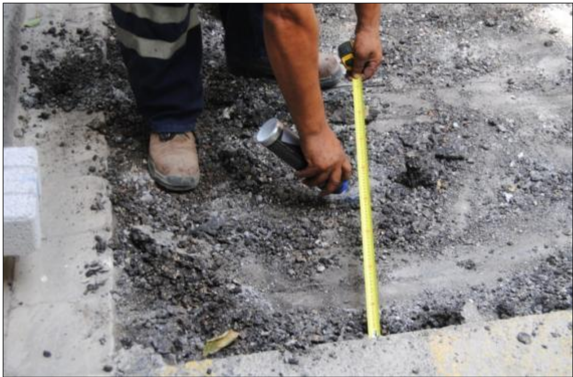
Figura 4. Es torna a delimitar amb esprai la mida de la cala un cop aixecat el primer nivell d'asfalt.
