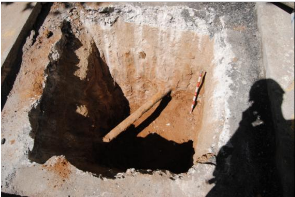
Figura 64. Cala 21. Nivell d'argila remogut per un tub de ferro.
